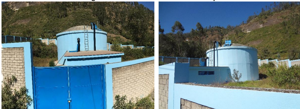
Imagen N° 31: Vista de Reservorio Colcaque
