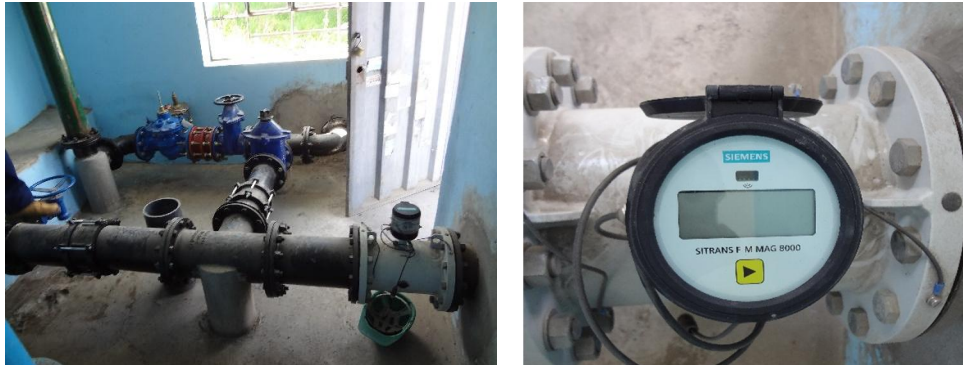
Imagen N° 24: Vista de instalaciones hidráulicas y macromedidor
