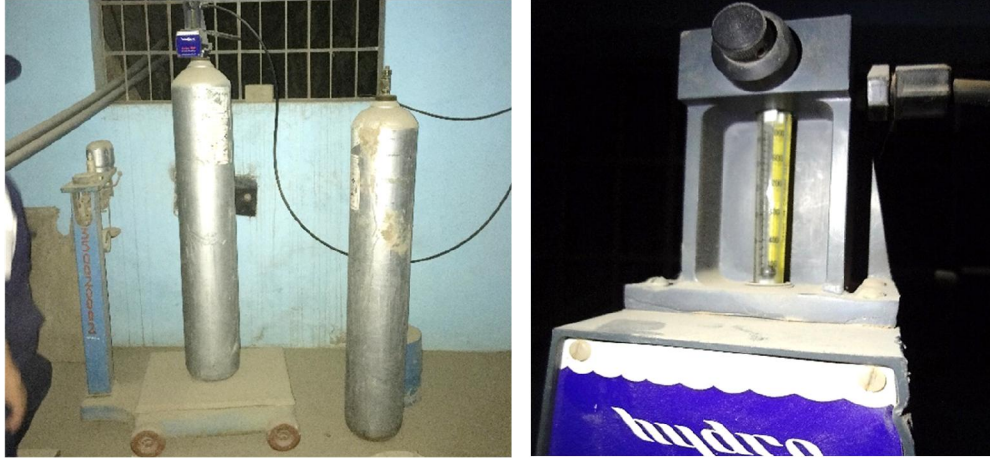
Imagen N° 19: Vista del sistema de cloración
