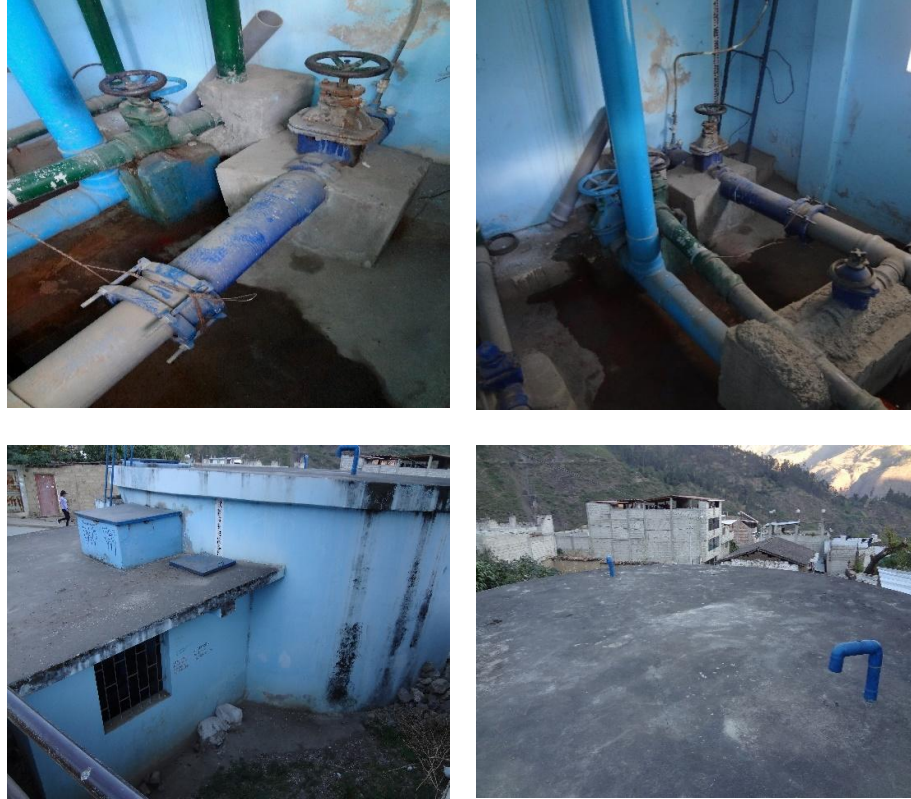
Imagen N° 28: Vista de instalaciones hidráulicas y macromedidor
