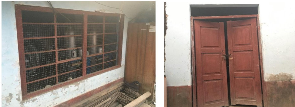
Imagen N° 16: Vista del sistema de cloración de Prado I y II
