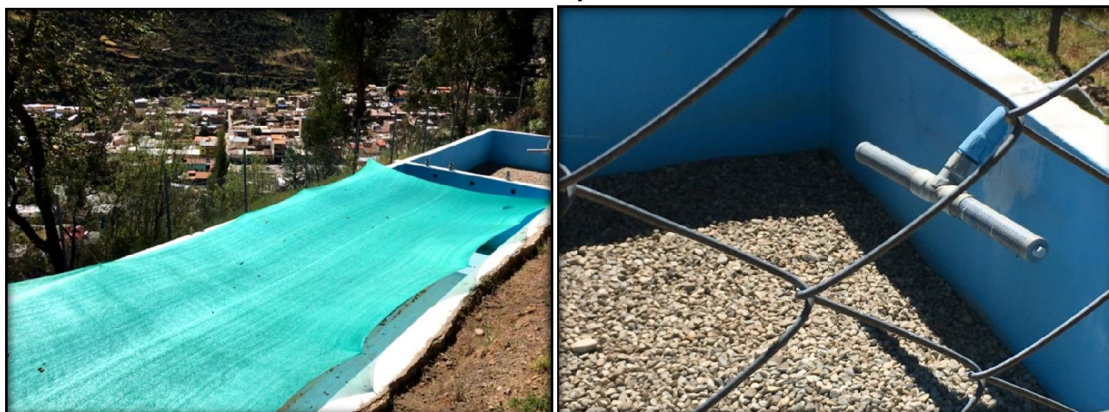
Vista de las unidades de Pre filtración y filtración de la PTAP-Comunita
