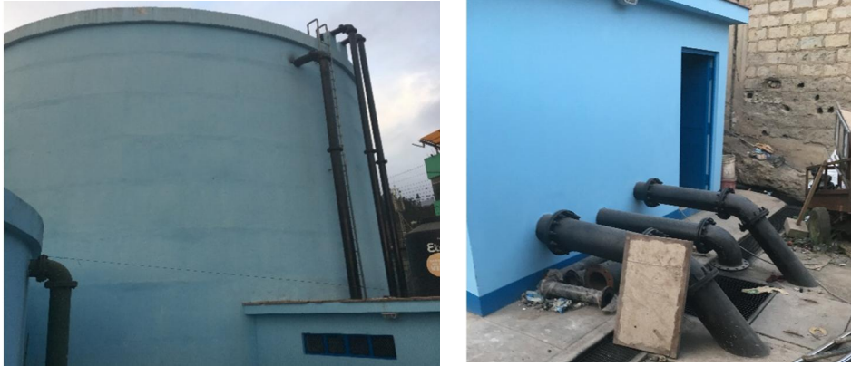
Imagen N° 14: Vista del Reservorio El Prado I (Nuevo)
