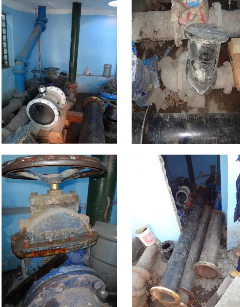
Imagen N° 26: Vista de instalaciones hidráulicas y macromedidor
