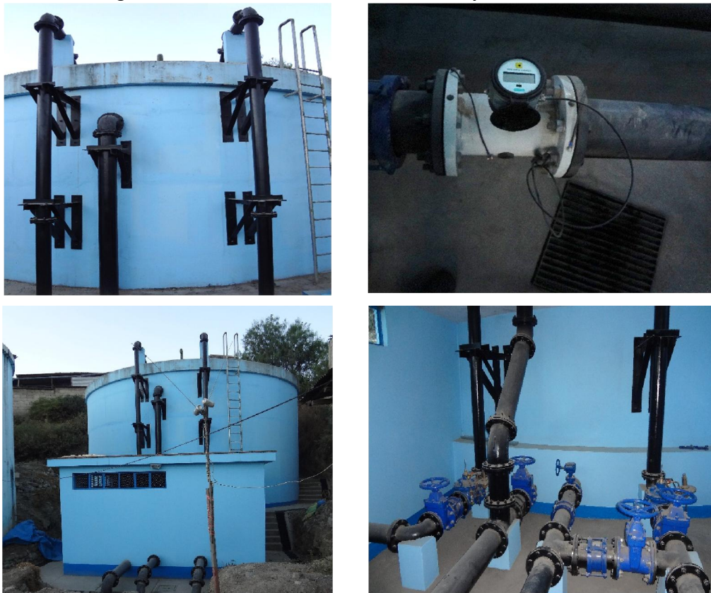
Imagen N° 18: Vista del Reservorio El Arco Nuevo y el macromedidor
