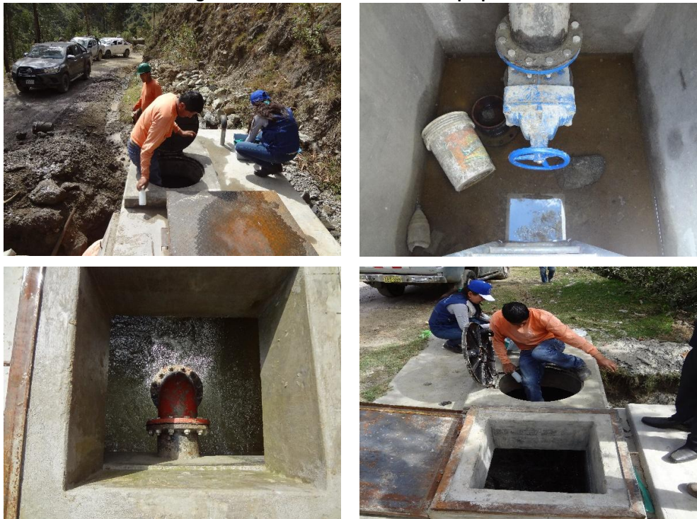
Imagen N° 35: Vista de la cámara rompe presión
