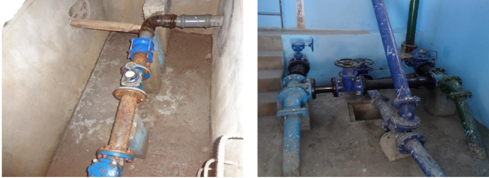
Imagen N° 21: Vista de las instalaciones hidráulicas y macromedidor
