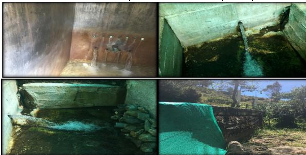
Fuente: Visita de campo 21/06/2019 Elaboración: Dirección de Regulación Tarifaria (DRT) – SUNASS
